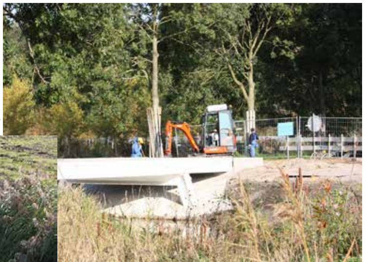
De bouw van de brug in de Tom Schreursweg ten oosten van het viaduct van de Westrandweg is bijna gereed
